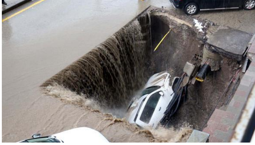
Resim 1. Çaykara Caddesi üzerinde meydana gelen göçük
