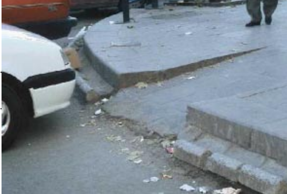
Resim . Standartlara uygun olmayan bir rampa
