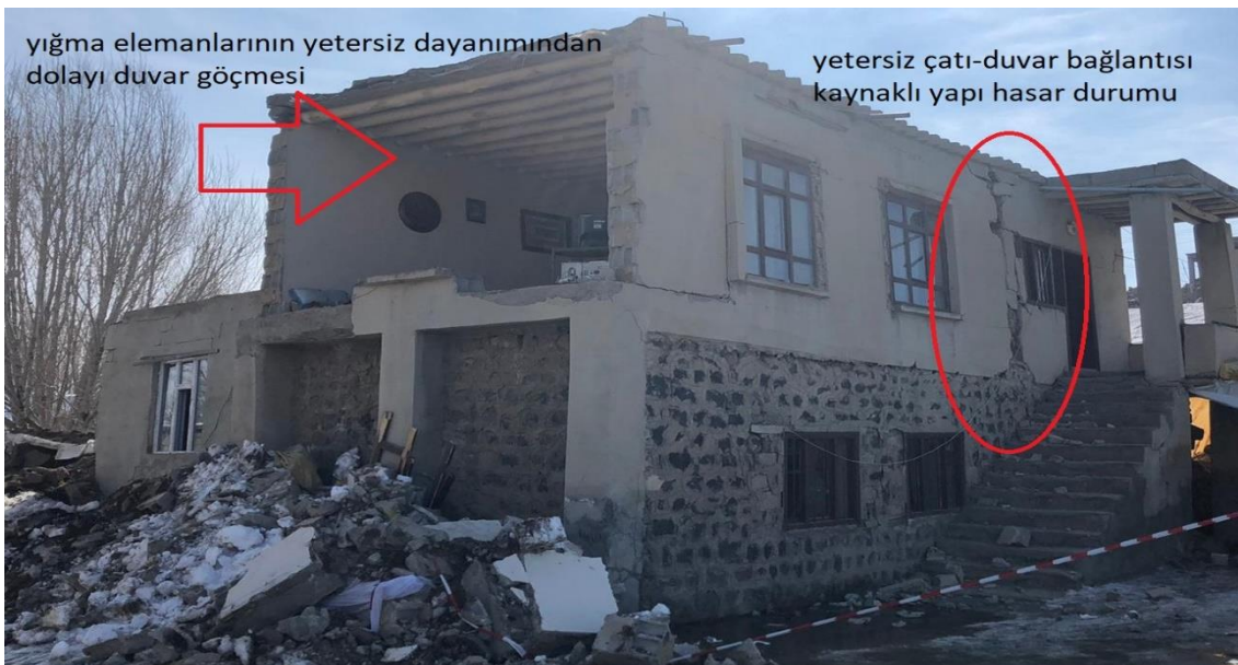
Şekil 18-Yetersiz çatı-duvar bağlantısı kaynaklı yapı hasar durumu
