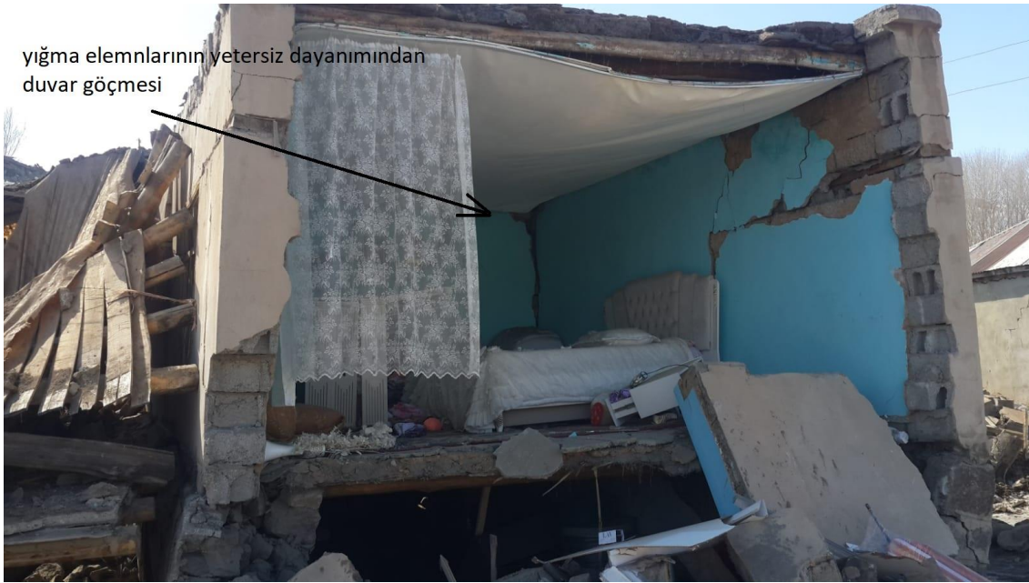
Şekil 17-Yığma elemanlarının yetersiz dayanımından duvar göçmesi
