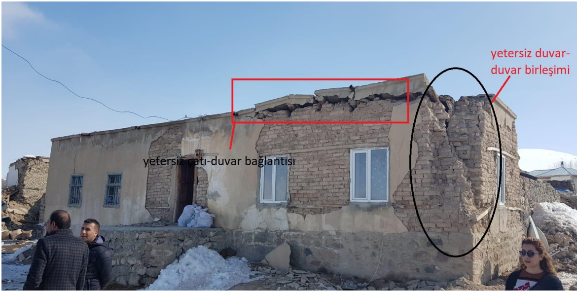
Şekil 15- Mesnetlenmemiş çatı-duvar bağlantısı
