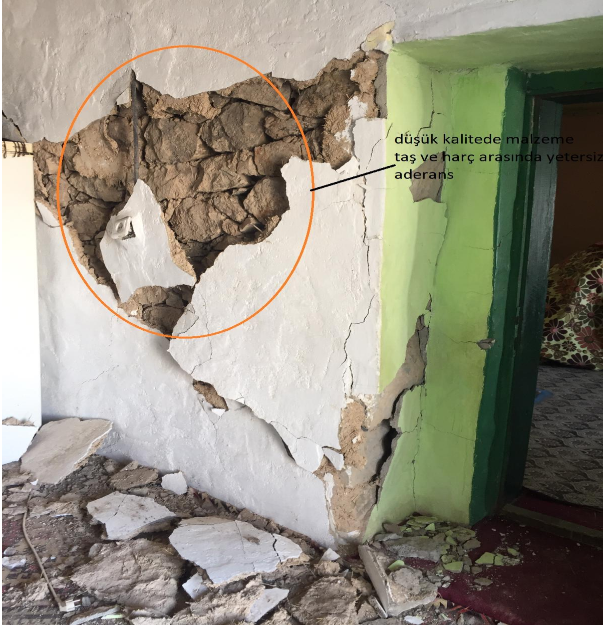
Şekil 14- Düşük kaliteli yığma malzeme kullanımından kaynaklanan düzlem dışı davranış.
