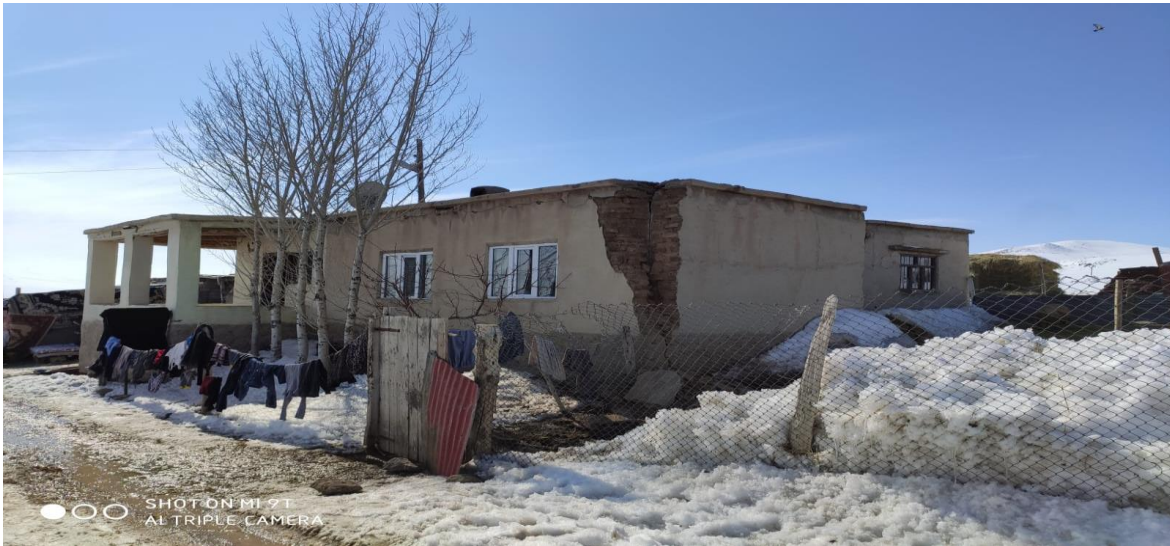
Şekil 16- Mesnetlenmemiş duvar-duvar bağlantısı
