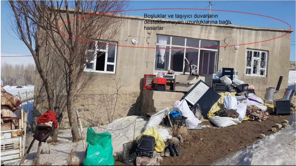
Şekil 20-Boşluklar ve taşıyıcı duvarların desteklenmeyen uzunluklarına bağlı hasarlar
