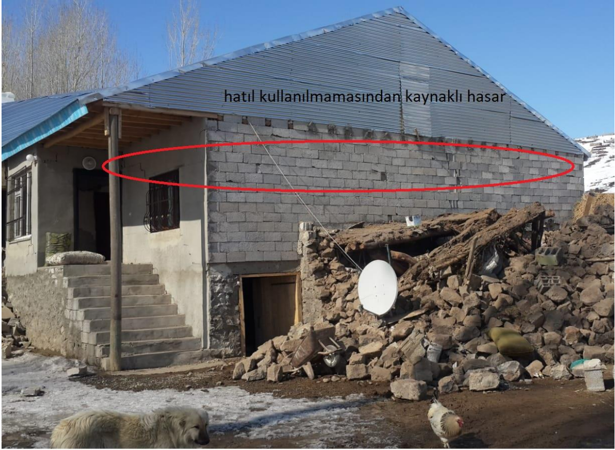
Şekil 19-Hatıl kullanılmamasından kaynaklı hasarlar
