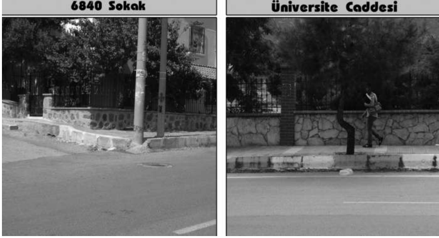
Şekil 2. Yaya Kaldırım Kaplamalarında Hatalı Uygulamalar
